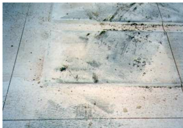
図一17 9mm鋼板段差部拡大
